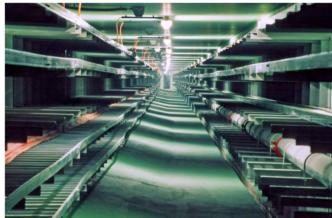
Obr. IX.14-1 Technická chodba v tunelu Mrázovka
